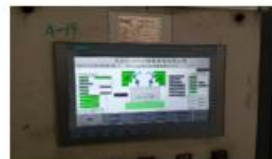
工作站触摸屏与PLC机器人系统进行升级，增加可视化窗口、提高维修效率
